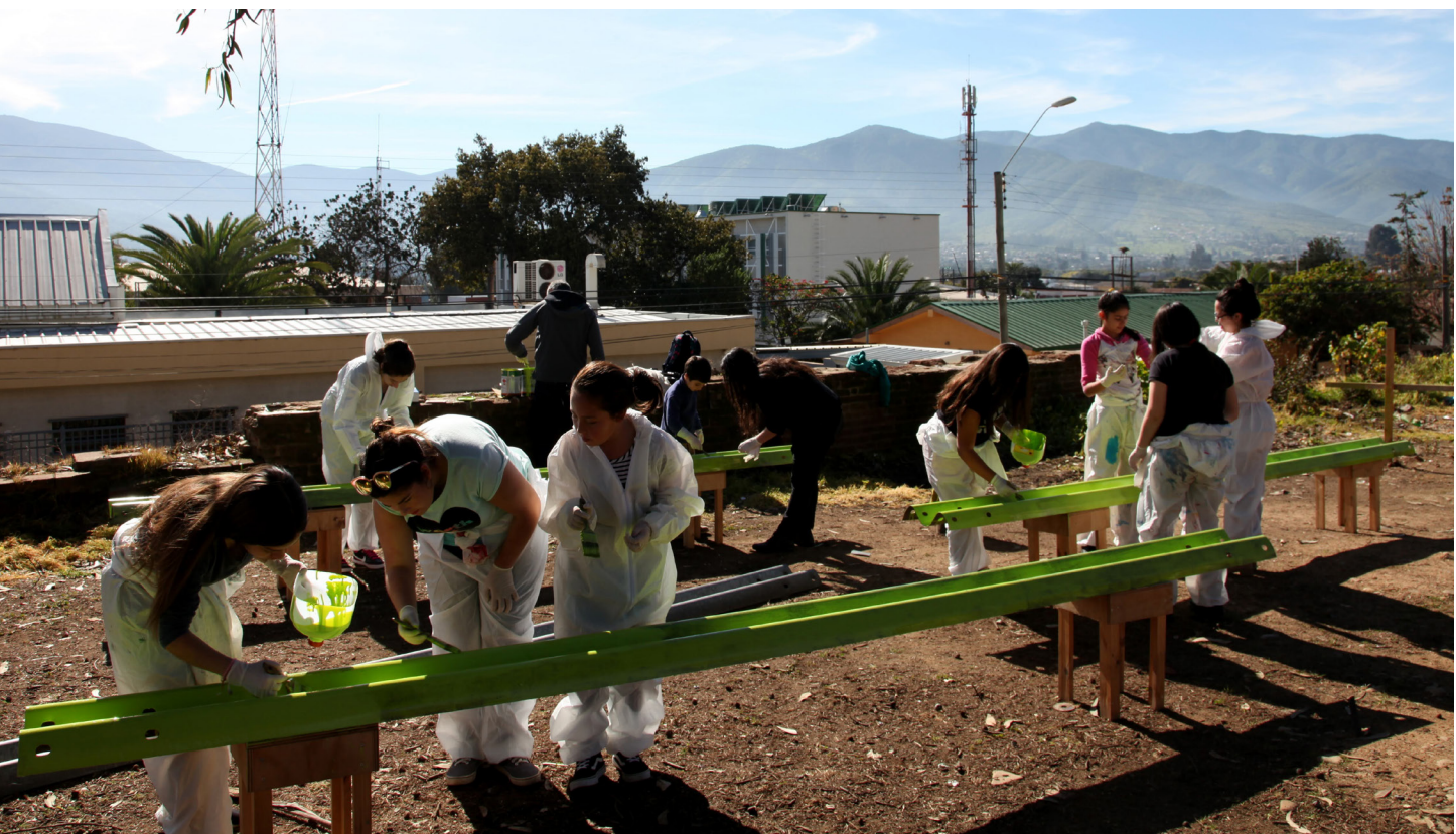
CONSTRUCCIÓN CASA EN EL ÁRBOL - CEECREA LA LIGUA © MINISTERIO DE LAS CULTURAS, LAS ARTES Y EL PATRIMONIO
